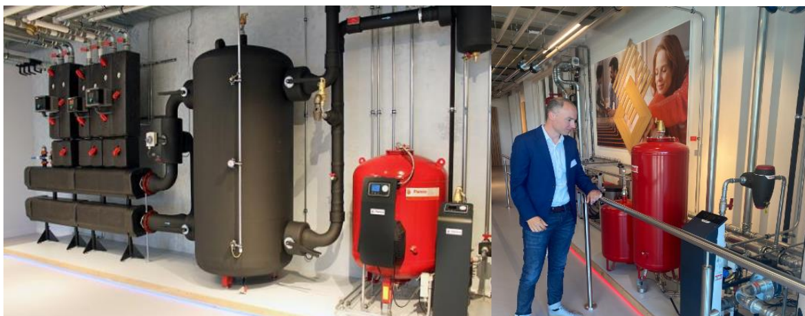
Links: energie efficiënte koelte- en warmteinstallatie van Aalberts; Rechts: Analist Bastiaan Rogmans tijdens bezoek aan de nieuwe productielocatie van Aalberts Hydronic Flow Control in Almere.
